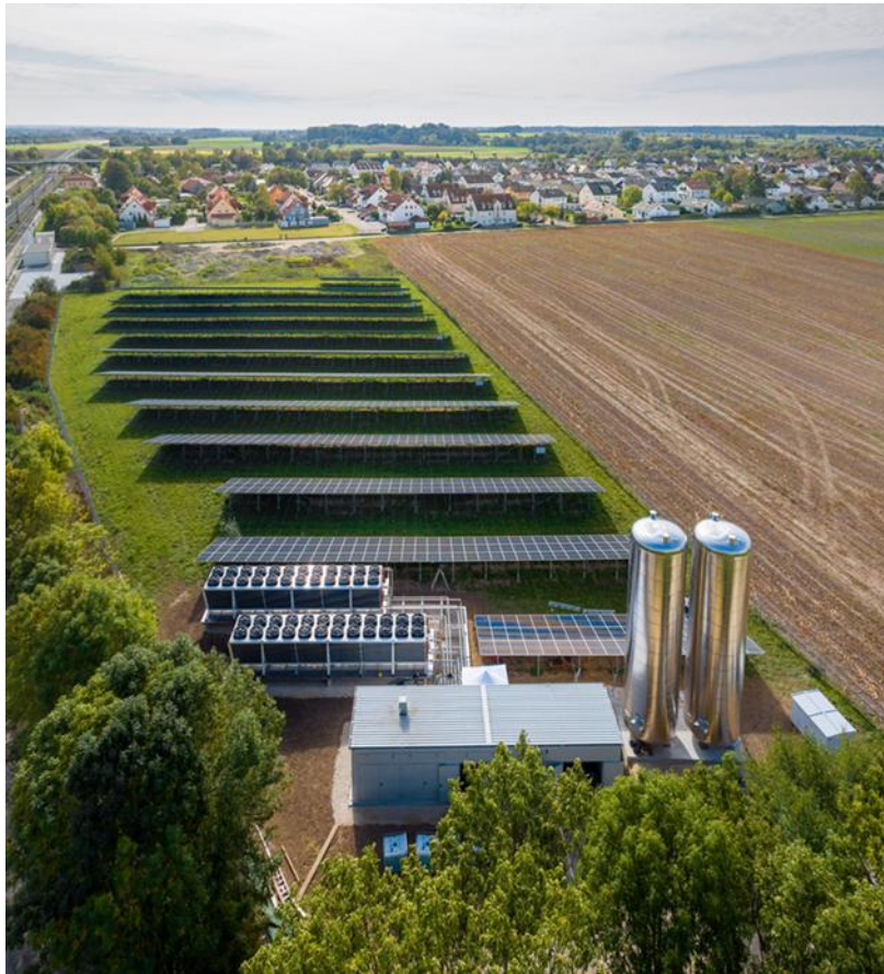
Abbildung 43: Heizzentrale in Mertingen mit 2 Wärmespeichern á 84 m³ (Quelle: Eigenes Bild)
